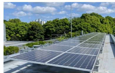
パルテノン多摩の屋上に設置されている太陽光パネル
